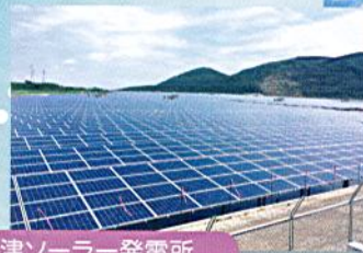
富津ソーラー発電所
